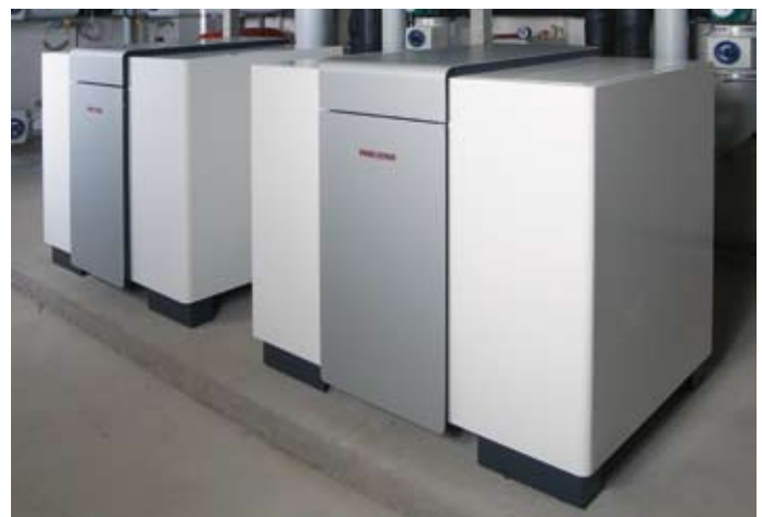
■ In diesem Technikraum einer Seniorenwohnanlage in Bottrop verrichten zwei Erdreichwärmepumpen „WPF 52“ von Stiebel Eltron in Kaskade geschaltet ihren Dienst. Sie sorgen für niedrige Heizenergiekosten für die Bewohner. Bis zu sechs solcher Geräte, mit wahlweise 22, 30, 46, 56 oder 69 kW Wärmeleistung, können bei Stiebel Eltron in Kaskade geschaltet werden, um dann maximal 400 kW Heizleistung bereitzustellen.
