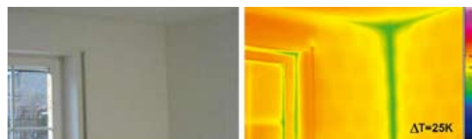
■ Bild 4 Innenthermografie, Oberflächentemperatur an der Gebäudeaußenkante vom Innenraum gesehen.
