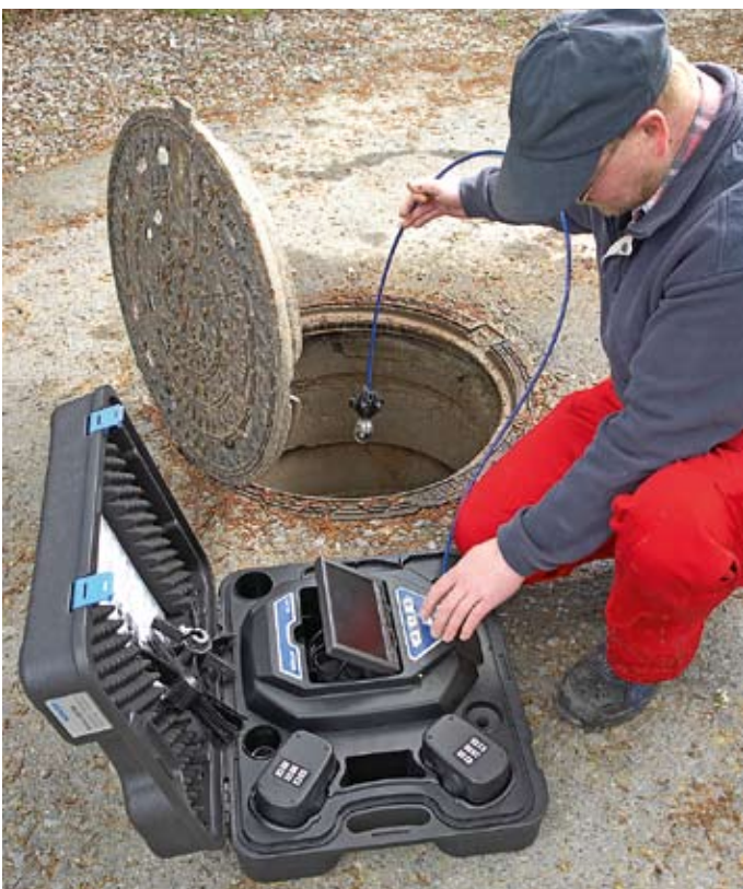
■ Die Dokumentation der visuellen Inspektion ist für den ausführenden Betrieb notwendig und für den Kunden interessant. Er bekommt damit einen Einblick in sein Abwassersystem.
