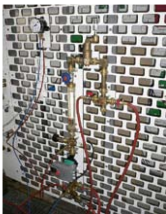
■ Der Messaufbau ermöglichte die Überprüfung des Differenzdruckes, der Durchflüsse sowie der Stromaufnahme der eingesetzten Pumpe.
