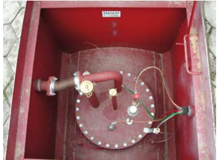
■ Bild 5: Ein ordnungsgemäß installierter Erdtank sorgt für eine sachgerechte Heizöllagerung. Dabei muss der Domschacht flüssigkeitsdicht ausgebildet sein. Ein Leckanzeigergerät kontrolliert, ob beide Wandungen des Tanks dicht sind. Bild: IWO
