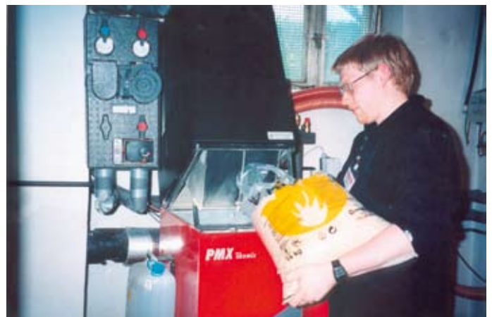
■ Bis zum erstmaligen Befüllen des Pelletaußenspeichers wurde der Vorratsbehälter am Kessel manuell mit Sackware beschickt.
