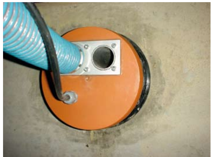
■ Wanddurchführung mit Adapterplatte, Saugschlauch, Stromkabel und Rückluftöffnung; vom Speicherinnenraum aus gesehen.
