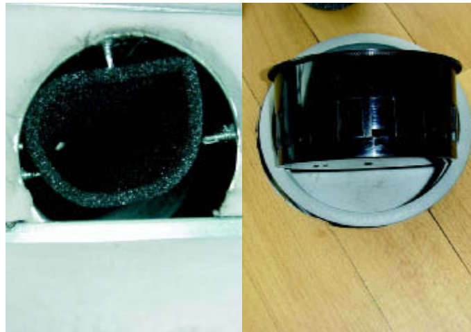
■ Bild 9: Bodenauslass mit einem unprofessionellen Versuch der Schallreduktion, der die Anströmgeschwindigkeit zusätzlich erhöhte und noch schlechtere Anströmverhältnisse zur Folge hatte.
