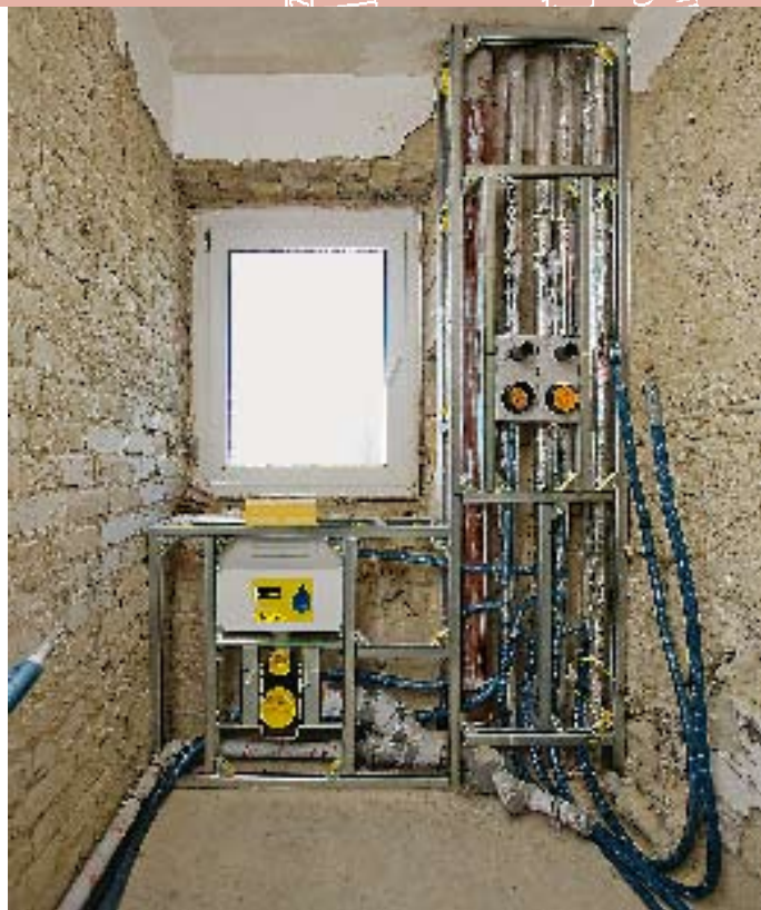
■ Mit der Systemtechnik von Viega, wie hier dem Steptec-Vorwandprogramm, ließen sich die Bäder ablauf-optimiert in kürzester Zeit kernsanieren.
