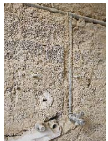
■ Stand der Technik aus den 60er-Jahren: Die Übertragung von Körperschall spielte bei der Rohrverlegung damals wohl eine eher nachgeordnete Rolle...
