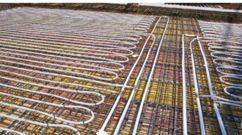
■ Die werkseitig von Uponor in Modulbauweise gelieferte Betonkernaktivierung „Contec“ wird über verpresste Verteil- und Sammelleitungen nach dem Tichelmanprinzip angeschlossen.
