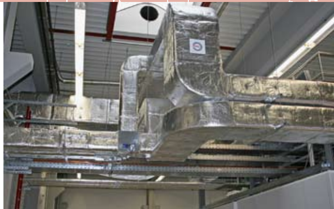
■ Versorgungsstrang mit Lüftungs-, Rohr- und Elektroleitungen zwischen Technikzentrale und OP-Bereich.
