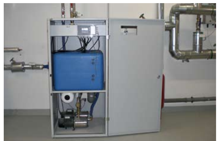
■ Regenwasser-Zentrale mit Druckerhöhungsanlage, Zwischenbehälter und Trinkwassernachspeisung.
