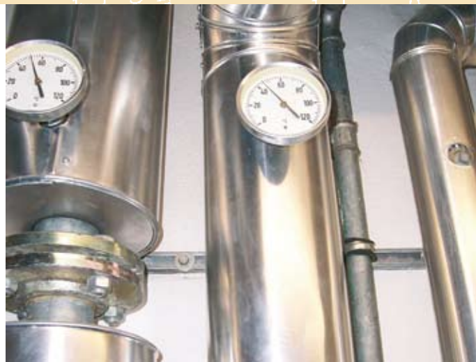
■ Planungsfehler: Die Warmwasser- und Zirkulationstemperatur befindet sich auf einem unzulässigen Niveau.
