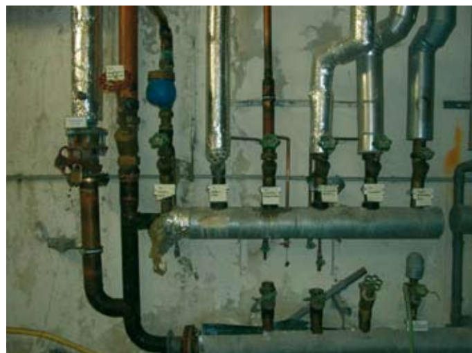
■ Installationsfehler: Bei diesem Trinkwasserverteiler fehlt die Wärmedämmung. Außerdem ist eine ständige Durchströmung aller Anlagenteile nicht gegeben – Stagnation ist der Fall.
