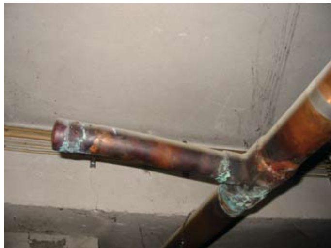
■ Installationsfehler: Diese unsachgemäß getrennte Abzweigleitung verursacht Stagnation.
