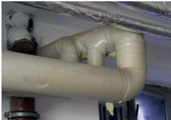
■ Installationsfehler: eine gemeinsame Dämmung für Kalt- und Warmwasserleitung.
