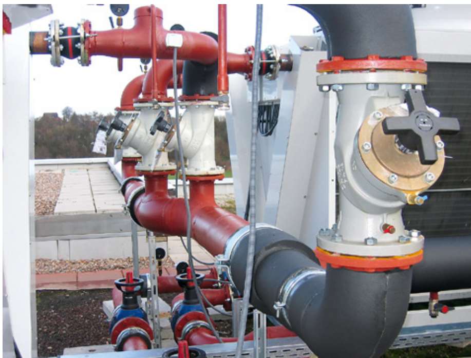
In größeren Heizungs- und Kältesystemen ist ein hydraulischer Abgleich der Verteilung erforderlich, um in einzelnen Leitungsabschnitten eine Über- oder Unterversorgung zu vermeiden.
