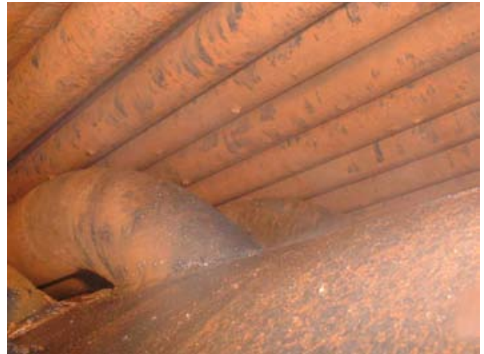
■ Beginnende Heizflächen-Verkalkung mit Segmentbildung.
