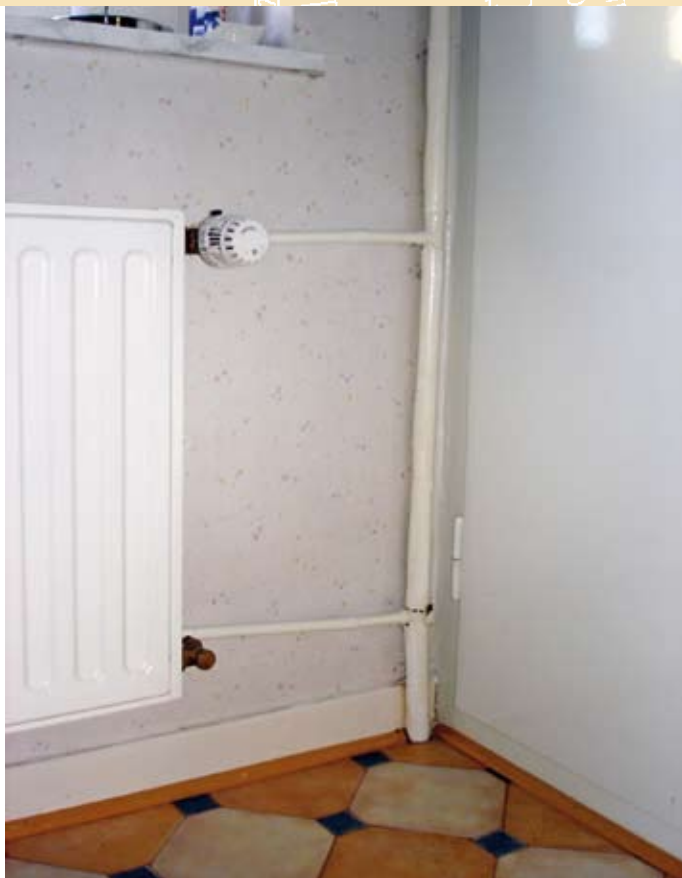
■ Senkrechter Einrohr-Strang in einer Küche. Im Teillastbetrieb der Anlage sind die Heizkörper oftmals alle abgedrosselt, sodass der Rücklauf deutlich angehoben wird.
