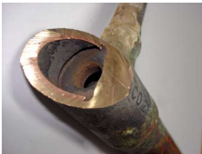
■ Aufgeschnittenes Venturi-T-Stück aus dem Rücklaufanschluss. Zu sehen ist die Drosselstelle vor dem Abzweig. Sie sorgt für den Unterdruck zum „Ansaugen“ des Heizkörper-Volumenstroms.
