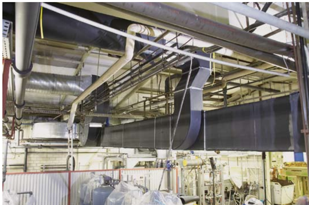
■ Klimakanäle über einem industriellen Waschband. Die rel. Luftfeuchtigkeit ist hier ein wichtiger Faktor zur Bestimmung der erforderlichen Dämmschichtdicke.
