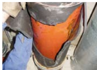
■ Schadensbild - Aufgrund offener Klebnähte hat sich zwischen Rohrleitung und Dämmung Kondensat angesammelt.
