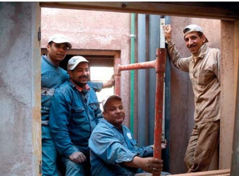
■ Stolz zeigen die ägyptischen Arbeiter die saubere Rohrführung der Trink- und Abwasserleitungen.
