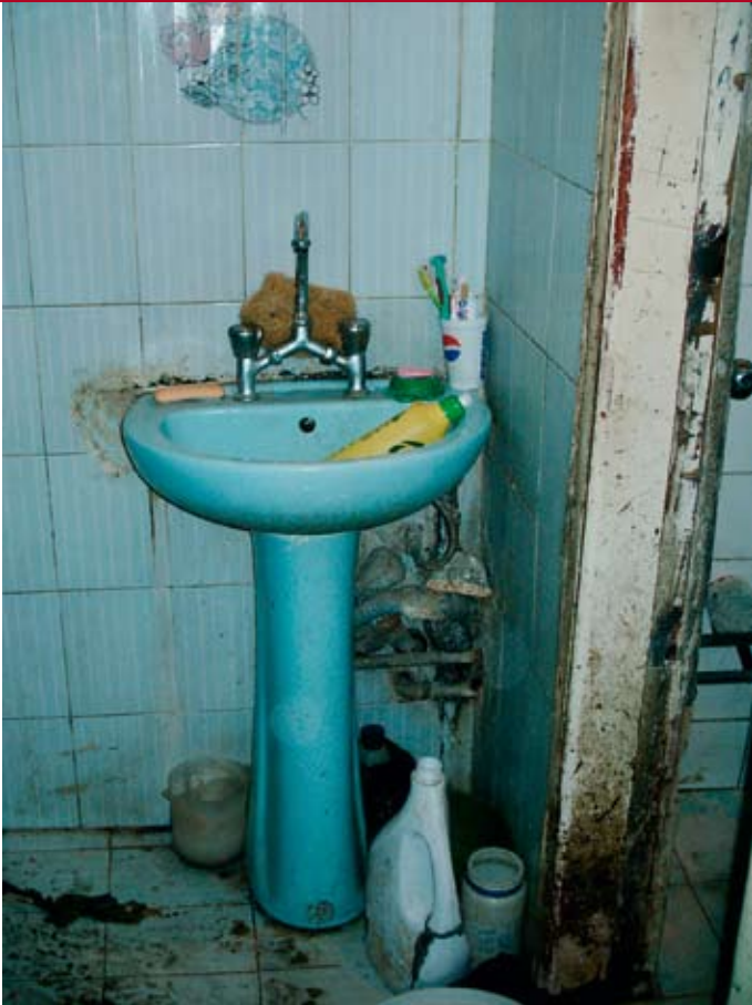
■ Waschtischinstallation im Stadtteil Darb Al-Ahmar in Kairo.
