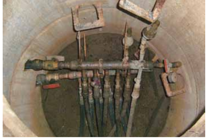
Bild 4: Semiprofessionell gebastelte Soleverteiler: Einstellmöglichkeiten und Absperreinrichtungen fehlen.
