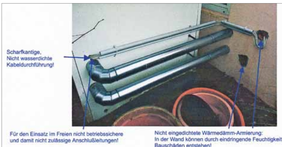
Bild 6: Auch in puncto Elektrik gibt es zahlreiches zu beachten. Hier sind gleich mehrere Fehler erkennbar.
