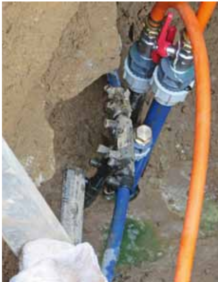
Bild 5: Undichte Erdsonde mit Glykolpfützen.
