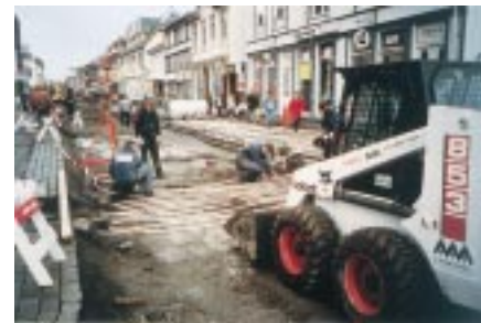
Rund 15 000 m Rohr sorgen selbst bei stärkstem Schneefall oder Minusgraden für freie Straßen.
