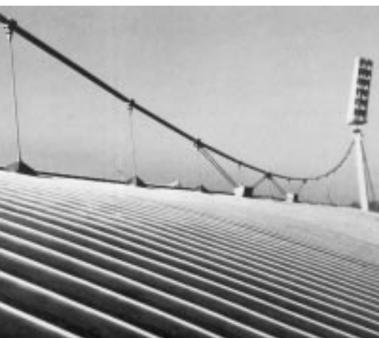
Bild 1: Doppelstehfalzdeckungen sind die am häufigsten ausgeführten Metalldächer, weil sie wirtschaftlich und besonders „langlebig“ sind. Ihre Ausführung gehört zu den traditionellen Arbeiten des Bauklempners und verlangt Erfahrung und handwerkliches Können.
