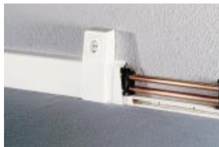
Bild 6: Extra hohe Sockelleiste für einen zusätzlichen Kabelkanal und Steckdosencontainer wie hier (oder für ein drittes Rohr).
