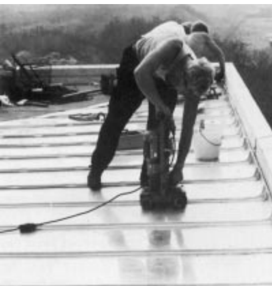
Bild 3: Auf der Baustelle: Schließen der Doppelstehfalze mit dem „Falzomat“. Die Wandanschlüsse wurden von Hand mittels „Quetschfalten“ hergestellt.
