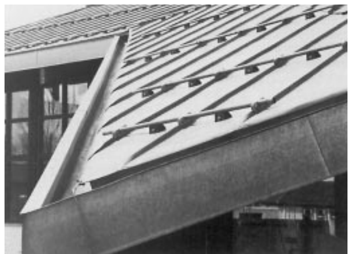
Bild 1: Schneefangvorrichtungen im Traufbereich eines Doppelstehfalzdaches. Die Befestigung der Fangrohre erfolgte mit Klemmlaschen, jeweils an den Doppelstehfalzen.
