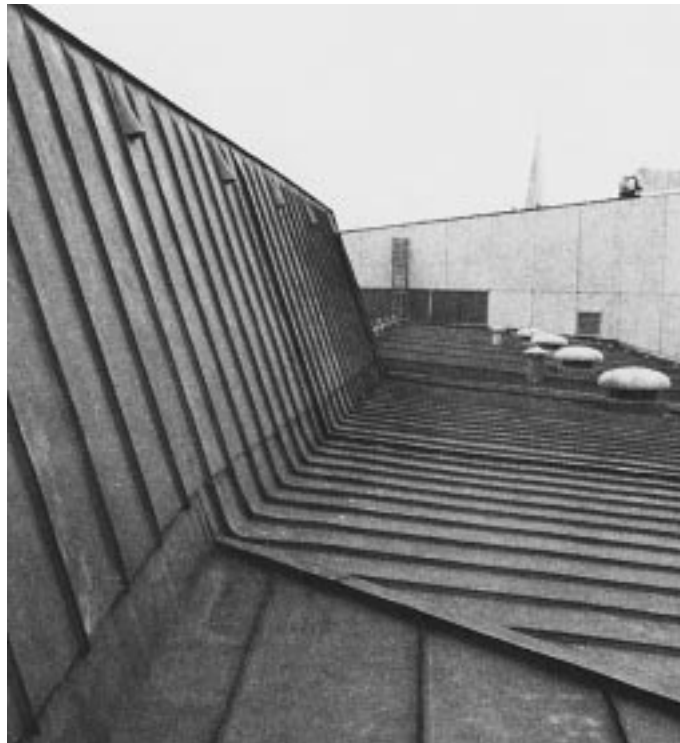
Bild 4: Unterschiedliche Anschlüsse im Bereich eines Dachaufbaues; wir sehen hier nebeneinander im linken Bildbereich einen Wandanschluß parallel zum Scharenverlauf und in der Bildmitte den Anschluß quer zur Scharenrichtung.
