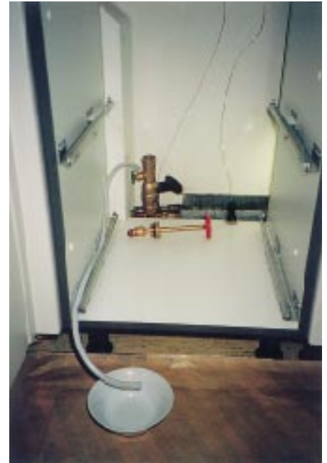
Mit dem handlichen Montagegerät „Monty“ von Heimeier ist selbst das Arbeiten in Zwangslage einfach. Der umsichtige Monteur hatte einen Schlauch parat, um den Ventilkörper durchspülen zu können, ohne Pfützen auf dem Boden zu hinterlassen. (Bild: Autor)
