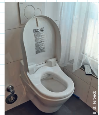
Bild 3: Fertiges Dusch-WC mit Fernbedienung (rechts auf der Fensterbank).
