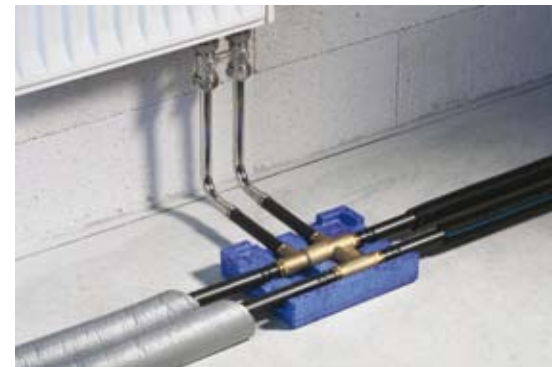
Heizkörperanbindung mit Mehrschichtverbundrohr, Kreuzungsfitting und Metallrohrbogen.
