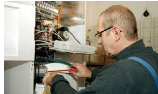
Befindet sich noch Luft in der Zirkulationspumpe, könnte dies die Ursache für eine mangelhafte Warmwasserbereitung sein.
