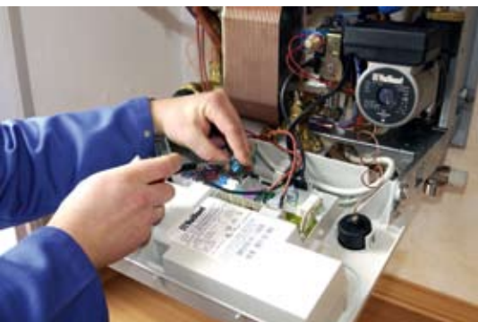
Neben den hydraulischen Gegebenheiten sind elektrische und elektronische Bausteine mitunter der Grund für eine unzureichende Warmwasserbereitung.
