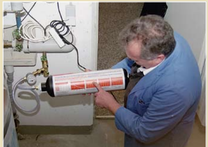
■ Bild 1: Ermittlung der benötigten Befüllpatronen und Anschluss an die Trinkwasserleitung.
