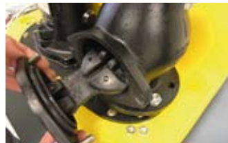
■ Bild 5: Überprüfung und Säuberung des Rückflussverhinderers.
