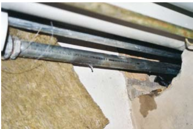
■ Leckage an einer Trinkwasserleitung. Als Ursachen für die Beeinträchtigung der Transportfunktion kommen insbesondere lokal verstärkte Korrosion und Inkrustation (Steinbildung, Korrosionsprodukte) in Betracht.
