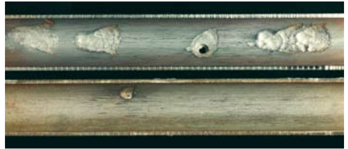
■ Korrosion an einer Trinkwasserleitung mit Durchbrüchen (Korrosion abgebeizt).
