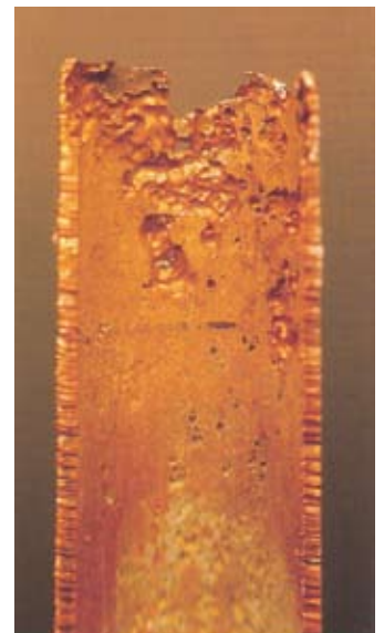
■ Muldenfraß an einem nicht entgrateten Rohrende aus Kupfer.
