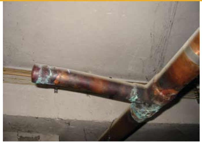
■ Totalleitung. Die unsachgemäß abgetrennte Abzweigleitung verursacht Stagnation und somit eventuell eine Kontamination in der Trinkwasseranlage.
