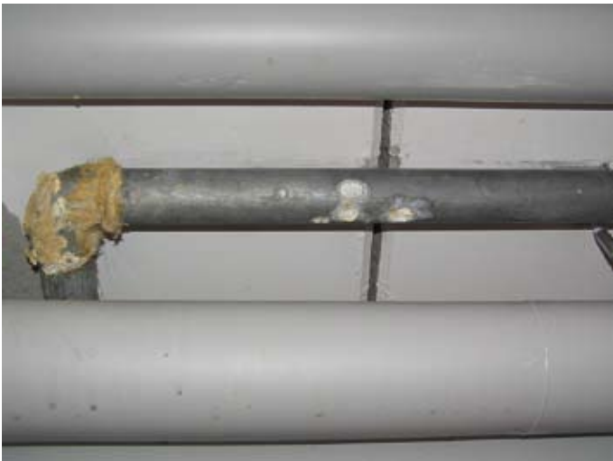
■ Korrosion an einer verzinkten Stahlrohrleitung - gerade rechtzeitig vor dem Wasserschaden entdeckt.
