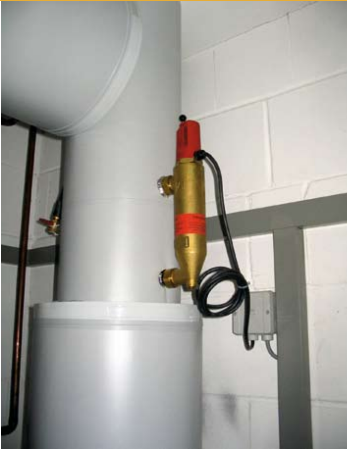
■ Die Einrichtung zum Schutz vor unzulässiger Erwärmung (hier: die Wassermangelsicherung WMS) ist gemäß DIN EN 12828 für alle Anlagen obligatorisch. Sie kann aber – je nach Leistung – durch mehrere Alternativmaßnahmen ersetzt werden.
