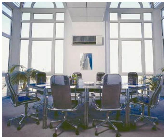
■ Inneneinheit eines Split-Klimagerätes als Wandgerät. Diese Anlagen eignen sich auch für die Kühlung von größeren Räumen über 35 m 2 Grundfläche.
