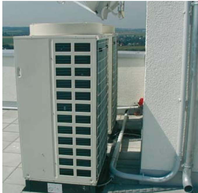
■ Außeneinheit eines Multi-Split-Klima-Systems. Ein Vorteil: mit einer Außeneinheit können mehrere Inneneinheiten versorgt werden.
