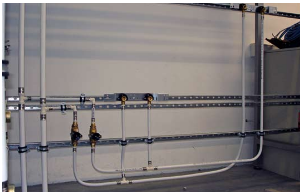
■ Eine gewissenhafte Dimensionierung von Trinkwasserinstallationen hilft Hygieneprobleme im späteren Betrieb vorzubeugen.
