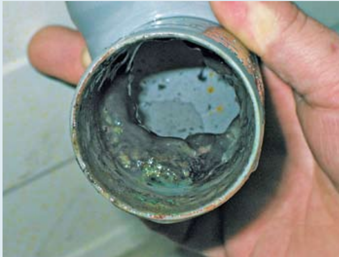
■ Massives Biofilmwachstum (ebenfalls aus einem untersuchten Hochdruckbefeuchter).
