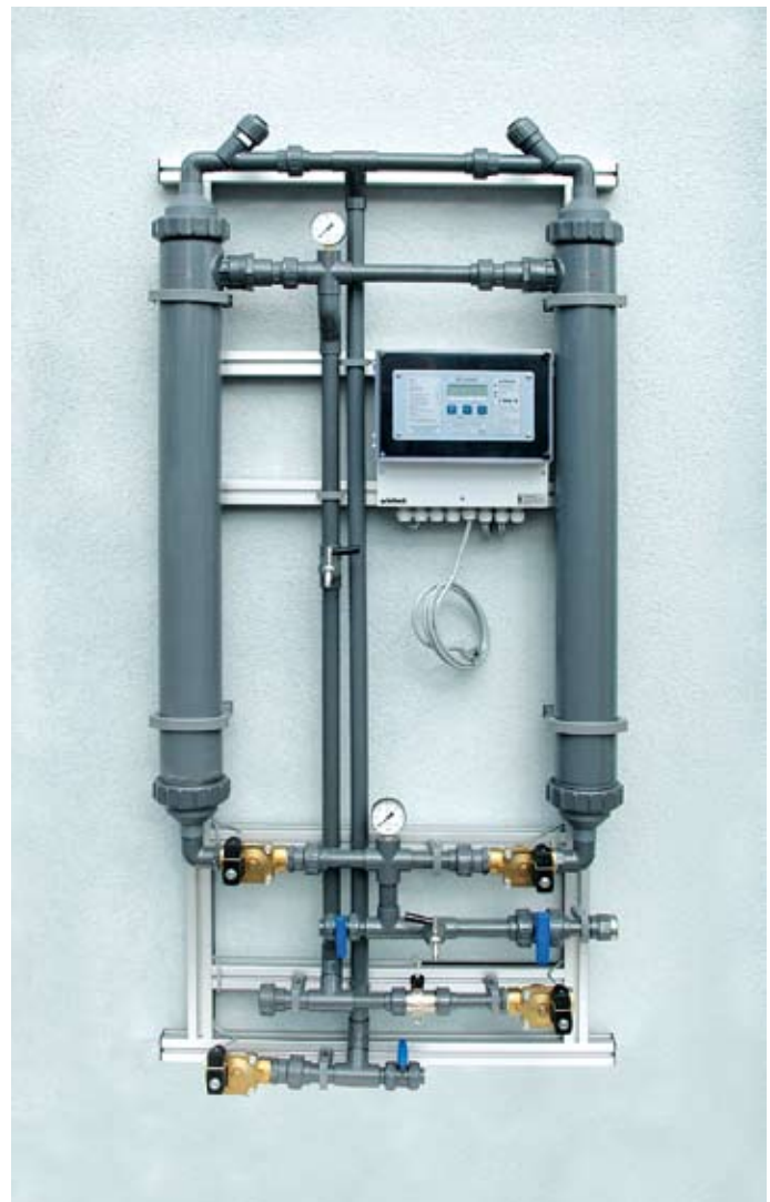
■ Zur Qualitätsüberwachung der Ultrafiltrationsanlage ist vor und nach der Anlage je ein abflammbarer Probeentnahmhahn eingebaut. Spülintervalle zur Reinigung der Membranen sind über die Steuerung einstellbar.
