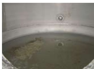
■ Bild 6: Im Speicher befand sich etwa eine Handvoll Kalk, der vom Wärmetauscher abgeplatzt war.
