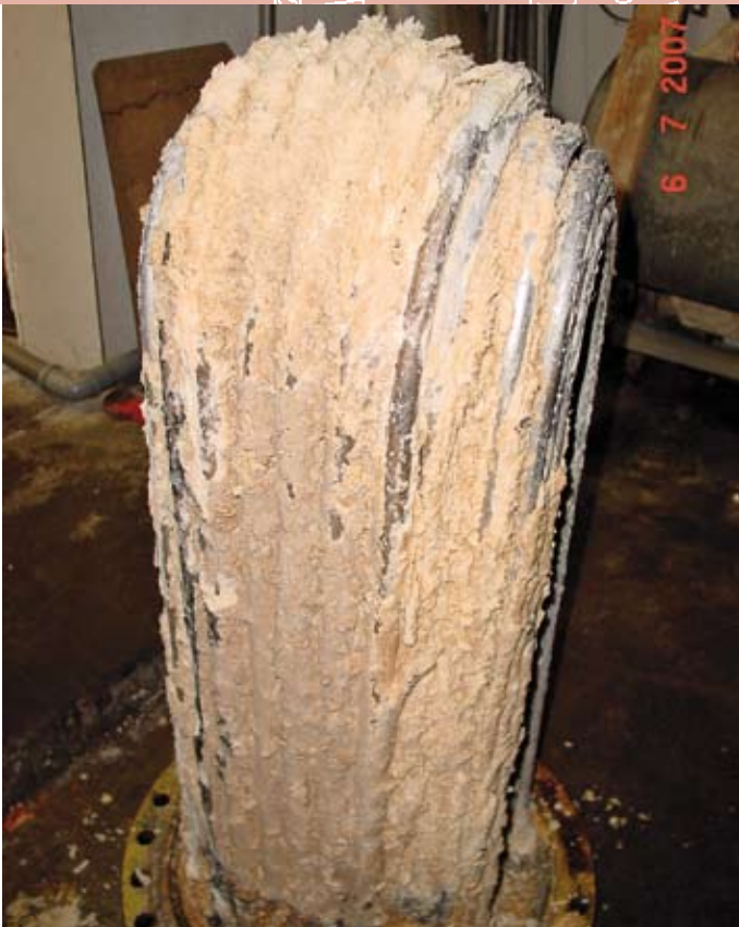
■ Bild 1: Kalkausscheidung im großen Stil: Bereits nach einer Einsatzzeit von etwa fünf bis sechs Monaten musste der Wärmetauscher des Warmwasserspeichers durch einen zweiten Tauscher gewechselt und gereinigt werden.
