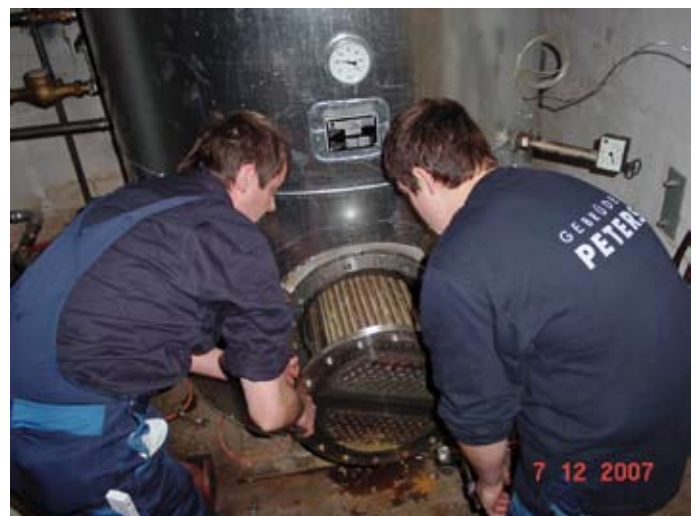
■ Bild 4: Abschluss der Testphase: Der mit Spannung erwartete Augenblick nach fünf Monaten und einem Heißwasserverbrauch von 4 500 000 l brachte das erwartete Ergebnis: Der Rohrbündelwärmetauscher war fast zu 100 % kalkfrei.
