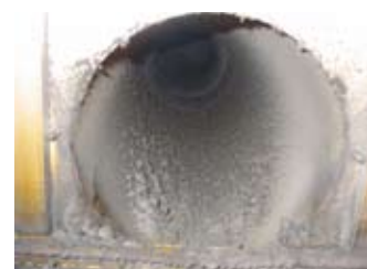
■ Bild 5: Durch Aerosolat und Staub verschmutzte Luftleitungen können große Brandlasten entstehen.
