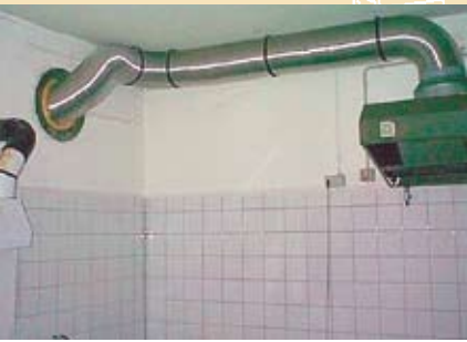
■ Bild 3: Unzulässige Installation: Flexible Luftleitungen dürfen für die Luftführung von Ab- und Fortluft nicht verwendet werden.
