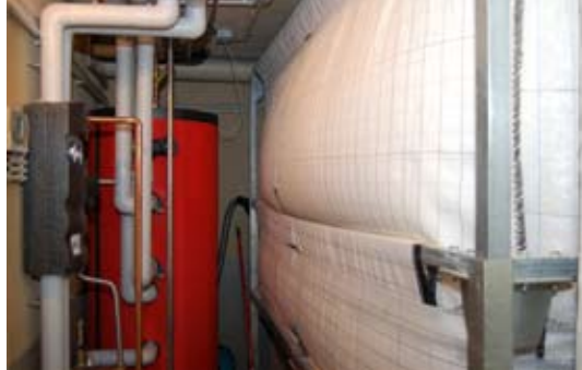
In diesem Fall steht ein Gewebesilo als Pelletlager neben einem Warmwasserspeicher.
