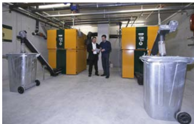
Große Pelletheizungen eignen sich hervorragend für Nahwärmenetze. Hier sorgen zwei Hackgut- und Pelletkessel für 300 kW Nennwärmeleistung.
