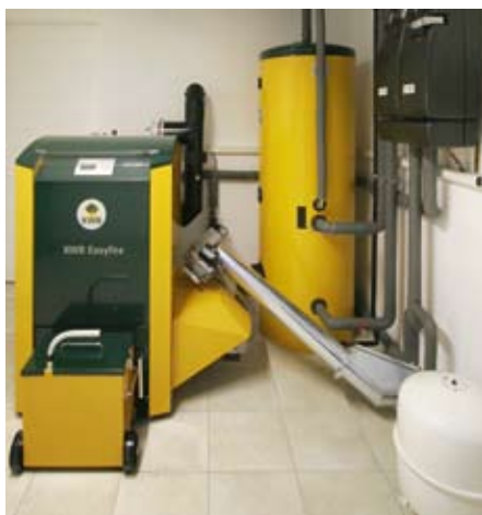
Eine Pelletzentralheizung mit 15 kW eignet sich hervorragend für ein bestehendes Einfamilienhaus. Laut KWB halbiert allein die neue Heizung den CO 2 -Ausstoß des Haushaltes.
