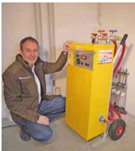
Der Zeitdruck in der Baubranche steigt, und mobile Heizgeräte können helfen, die Zeit der Estrich Trocknung zu verringern. Heizungsbaumeister und Geschäftsführer Bernd Kerscher (Karl Kerscher GmbH, Kühbach/Bayern) nutzt diese Technik seit Jahren. Bild: Mobiheat.
