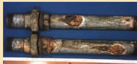
■ Durch Rost zugesetzte Stahlrohrleitung.
