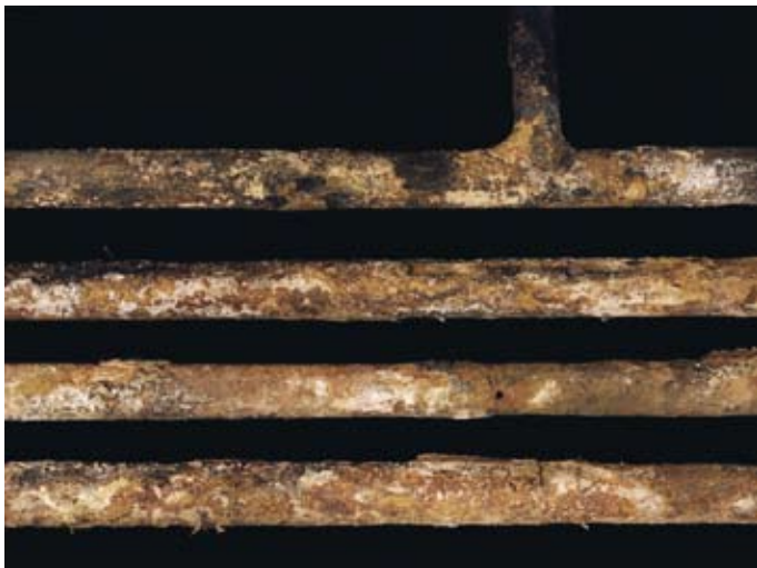
■ Unlegierter Stahl, korrodiert durch äußere Einwirkung von Feuchte.
