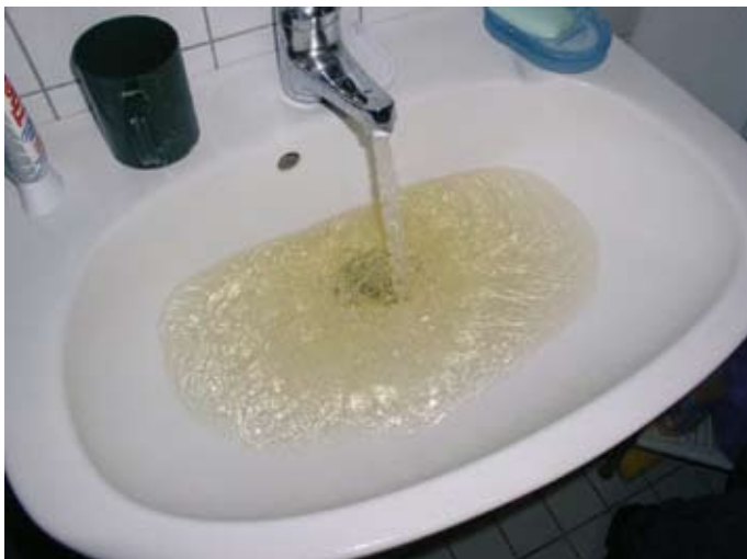
■ Verfärbtes Wasser durch Korrosionsvorgänge.
