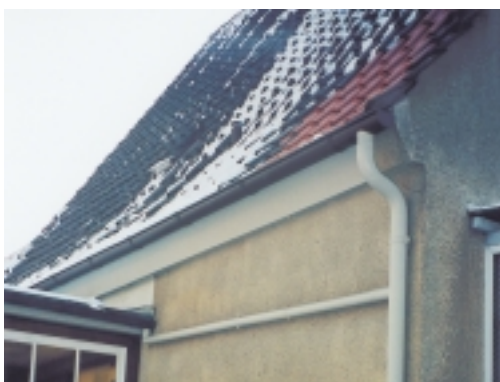
Absturzstelle vom Hausdach.
