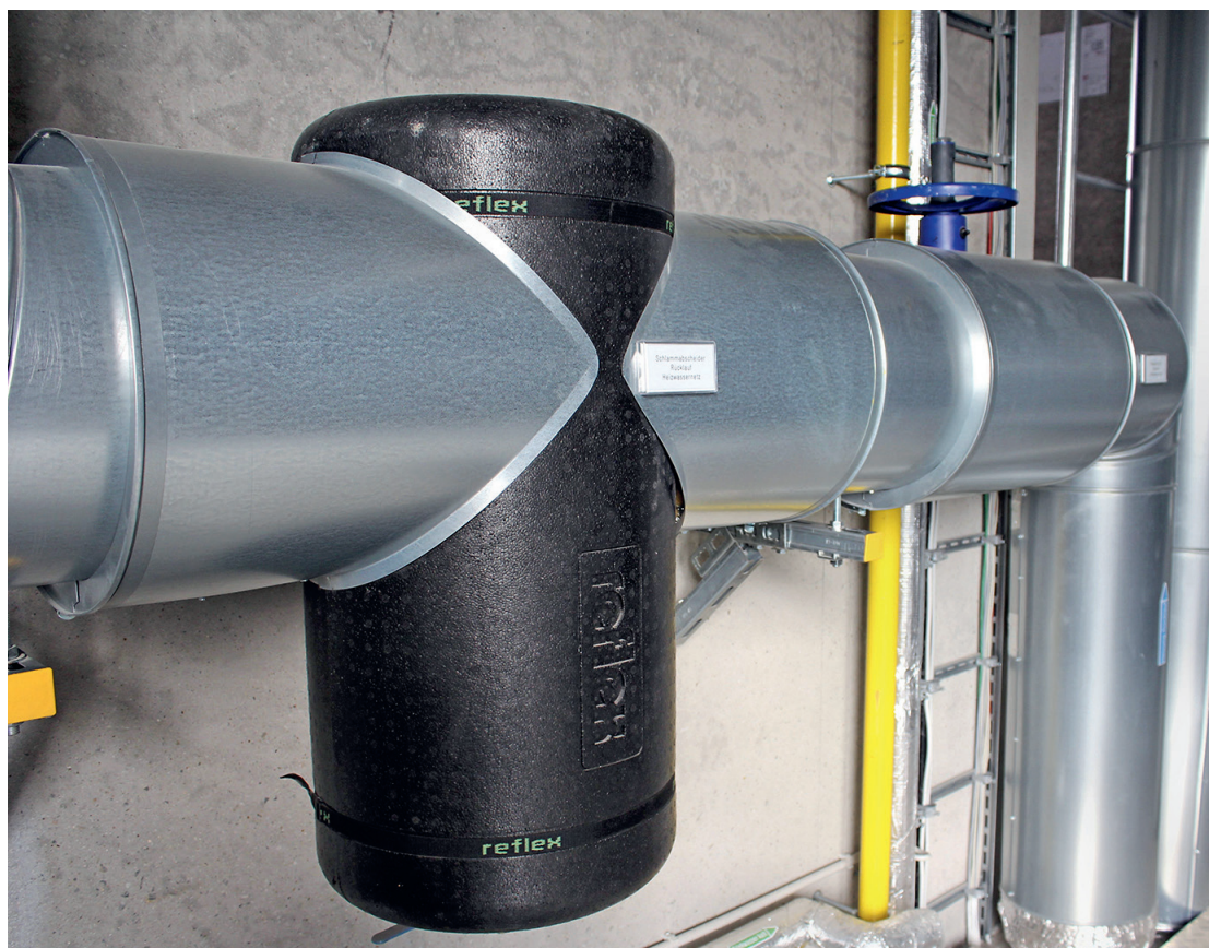
Auch in großen Dimensionen: Schlammabscheider in einer Technikzentrale für die Wärmeversorgung einer staatlichen Lehranstalt. Bild: Wolfgang Heini
